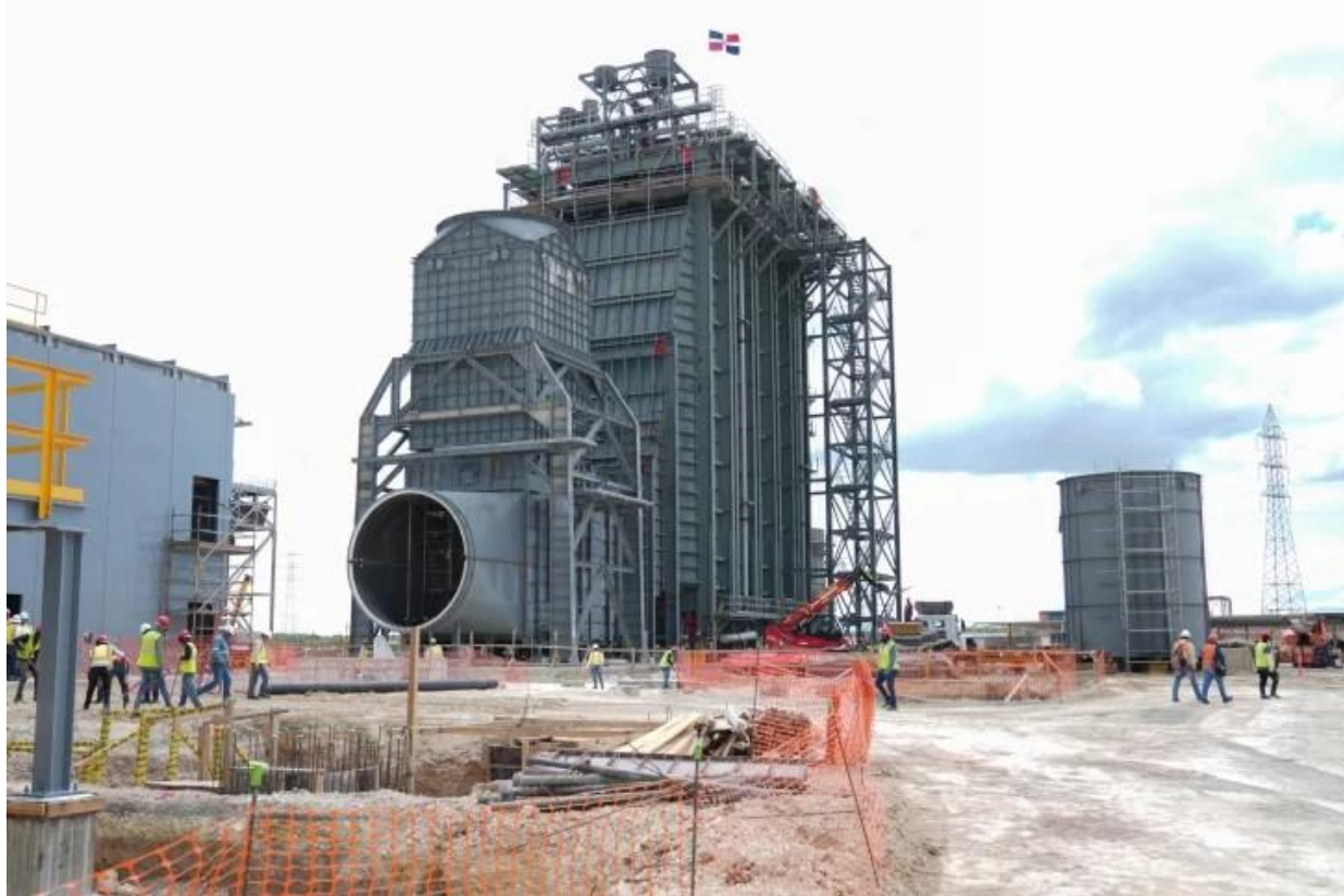
Central Térmica Manzanillo Power Land — 437.71 MW de ciclo combinado construidos sobre la base de un EIA diseñado para 60 MW en el año 2013. Jamás fue actualizado.
